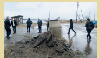
珠洲市内で隆起したマンホールを視察
